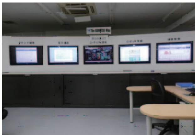
電力、設備の集中監視
