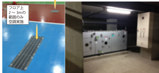
ピット内に設置した空調機器と床面の吹出口
