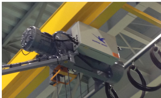
天井クレーン
