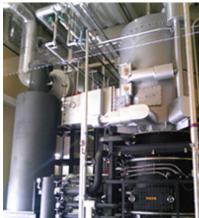
バイオマスボイラー（栗津工場）
