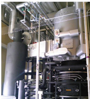
バイオマスボイラー（粟津工場）
