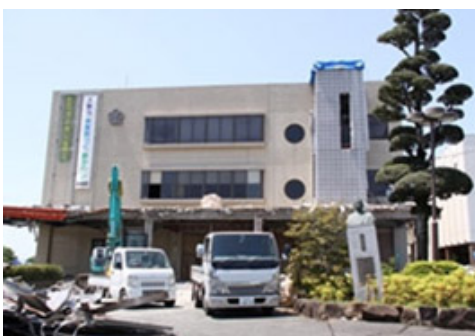
被災した益城町役場庁舎
