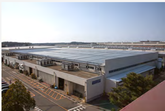
屋上に設置されたソーラーパネル
