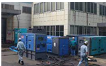
復旧支援例（発電機貸与、機械芯だし応援）
