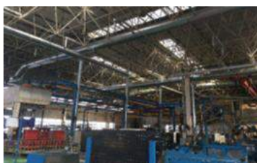
中国での規制対応例（大京機械山東有限公司：溶接ヒューム用集塵機・排気ダクトの設置）
