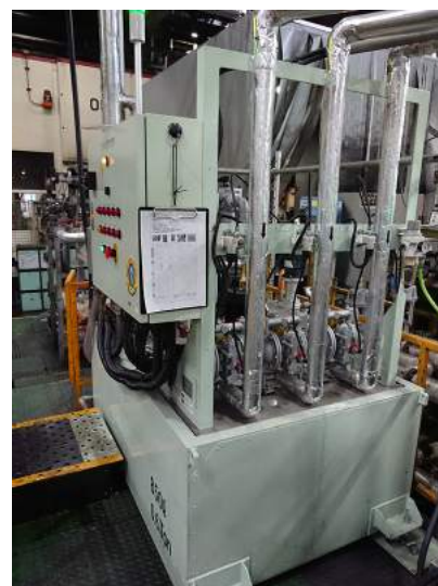
冷却水ろ過装置
