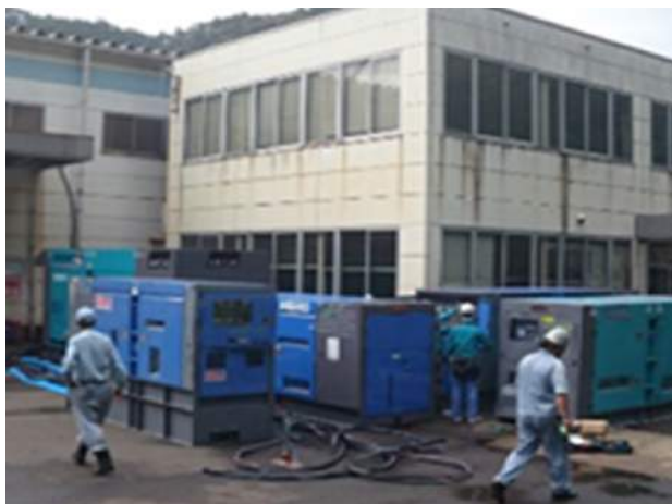
災害復旧支援（発電機貸与）
