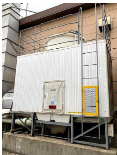
冷却塔（クーリングタワー）
