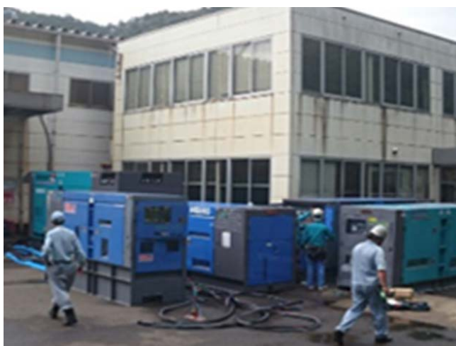
災害復旧支援（発電機貸与）
