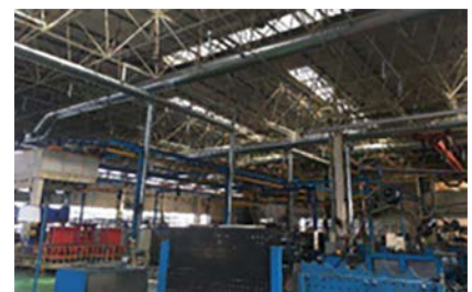
中国での規制対応例（大京機械山東有限公司：溶接ヒューム用集塵機・排気ダクトの設置）
