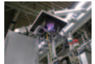
栗津工場熱処理炉での実証試験
