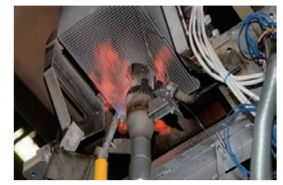
温度差で発電する「熱電素子」を使った廃熱発電システム(栗津工場)。熱処理は温度を急激に変化するので非常に過酷な条件です。
