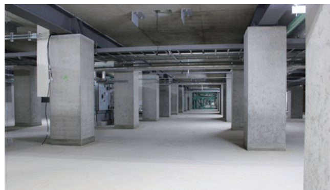
重量物を扱う工場として画期的な全面床下ピット。ライン周りがフラットになり、レイアウト変更も、床板を外し設備を移動させることで比較的容易に実現します。
